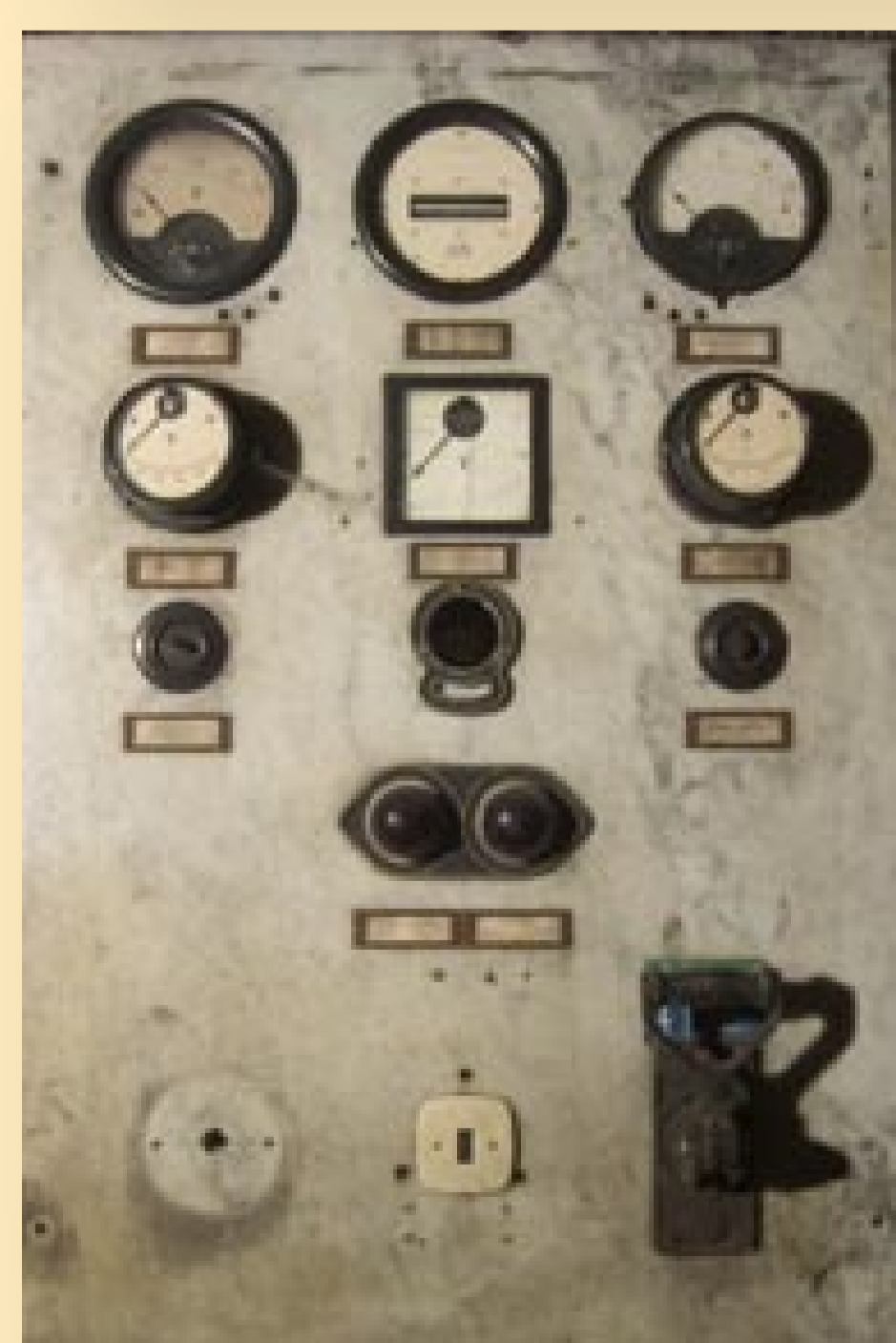
Historicky cenná mramorová rozvodnice – technický unikát.
